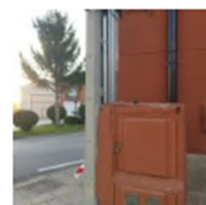
53. Postes de baja tensión en medio de aceras
