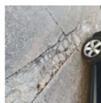
58. Socavón en asfalto en la subida ovejas
